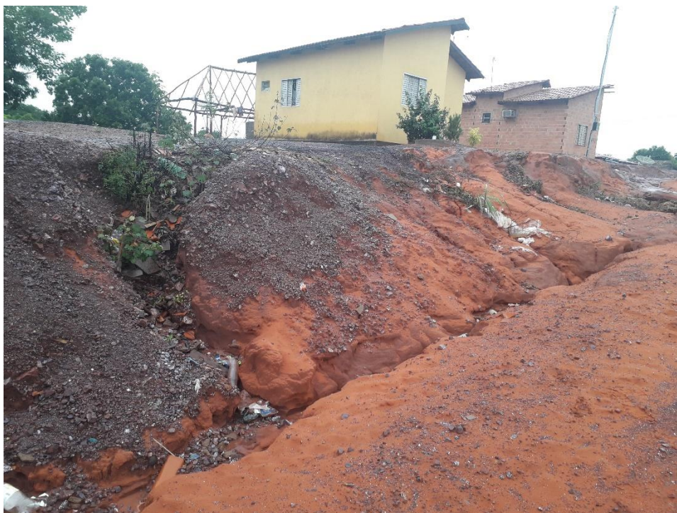
Figura 68 - Desbarrancamento e formação de sulcos profundos dados pelas águas pluviais em superfície sem proteção (rua não pavimentada), e construção em perigo de um possível desabamento
