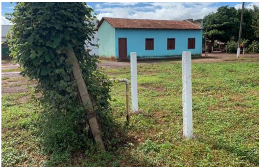
Figura 30: Foto do poço tubular profundo PTP 002 do SAA de Cachoeirinha
