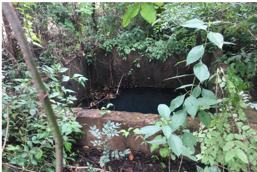
Figura 43 - Vista de EEE em Cachoeirinha (6°6'35.94"S e 47°54'39.99"O)
