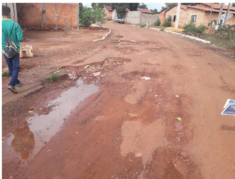
Figura 62 - Ponto facilmente alagável por ocasião das chuvas em rua pavimentada
