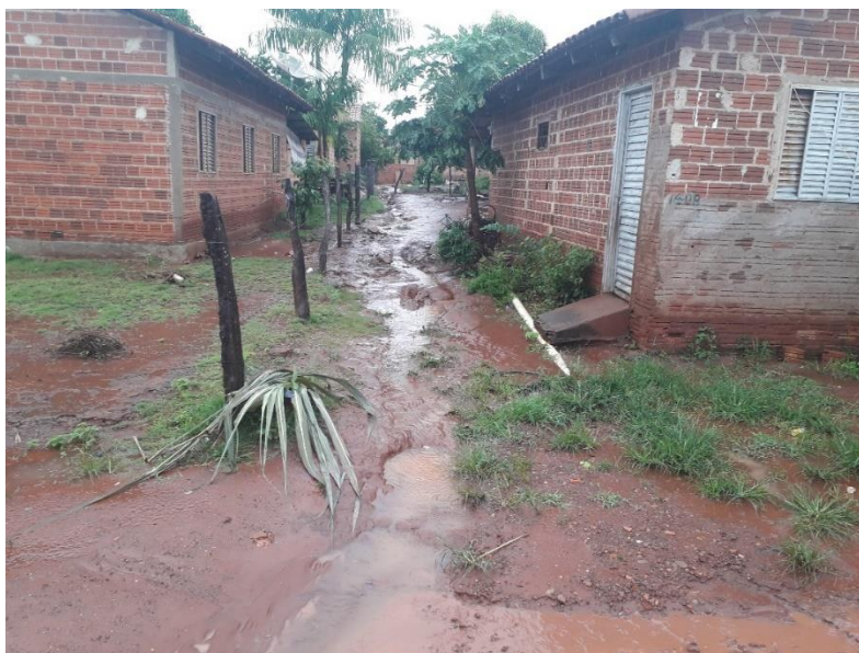
Figura 64 - Viela não pavimentada com valeta naturalmente formada pelas águas pluviais e de grande potencial erosivo de seu solo
