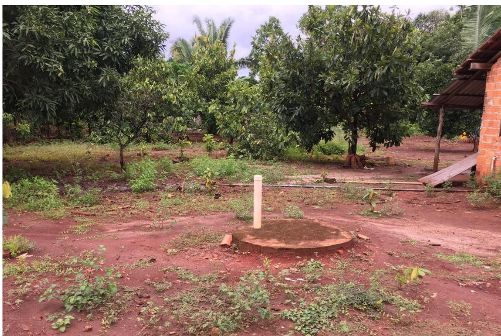
Figura 47 - Vista da fossa rudimentar instalada no setor urbano de Cachoeirinha (6°6'46.32"S e 47°56'36.45"O)
