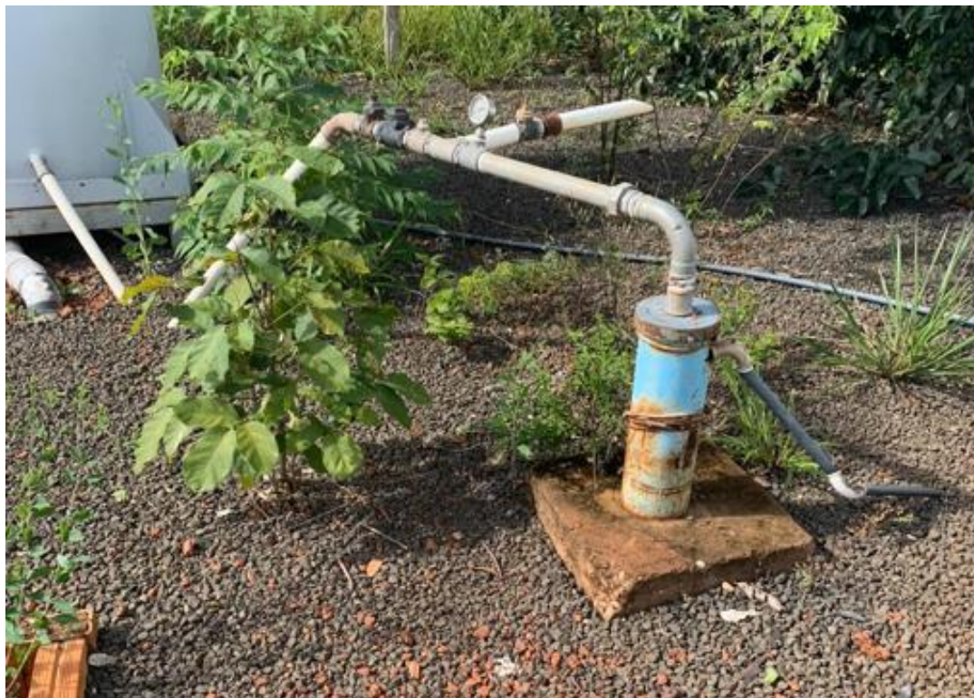
Figura 29: Foto do poço tubular profundo PTP 001 do SAA de Cachoeirinha;
