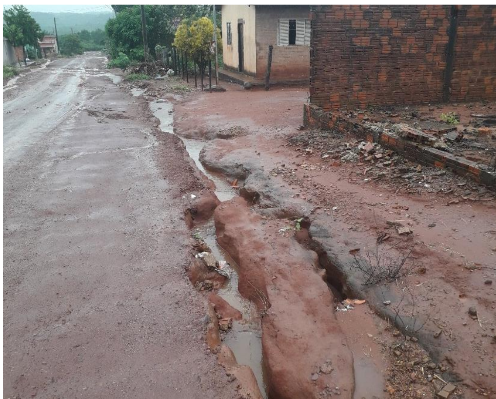
Figura 67 - Rua pavimentada, sem a devida proteção de meio fios e sarjetas
