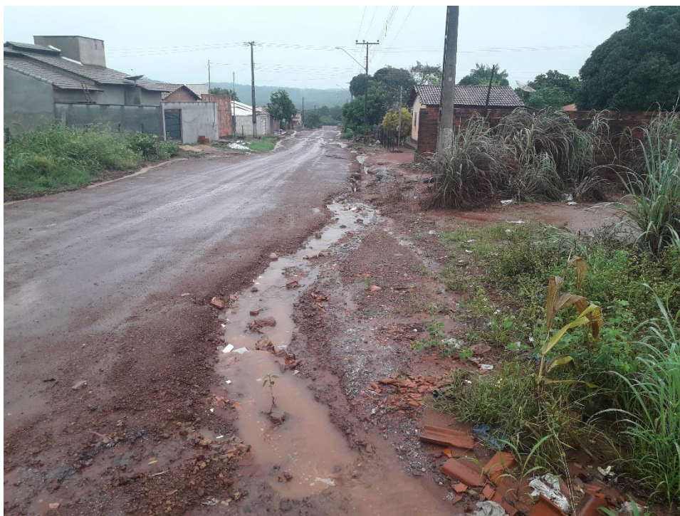
Figura 66 - Rua pavimentada, sem meio fio e sarjeta, inclinada para as margens, em que o escoamento de águas pluviais provoca erosão por sulco
