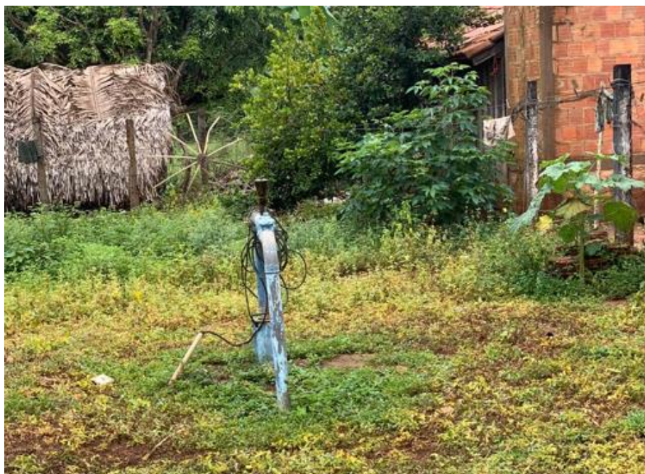
Figura 31: Foto do poço tubular profundo PTP 003 do SAA de Cachoeirinha
