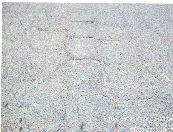
Foto 14: Pavimento com desgaste em alguns trechos.
