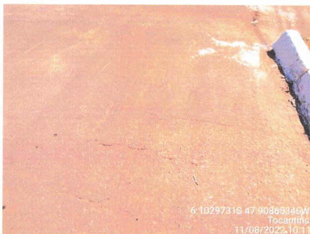
Foto 07: Pavimento com desgaste em alguns trechos.
