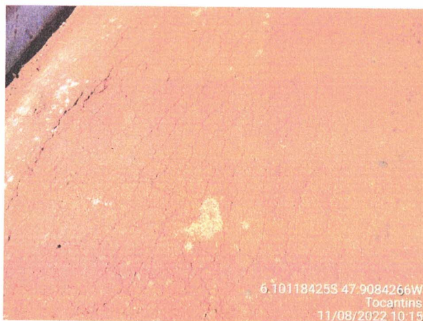
Foto 03: Pavimento com desgaste em alguns trechos.
