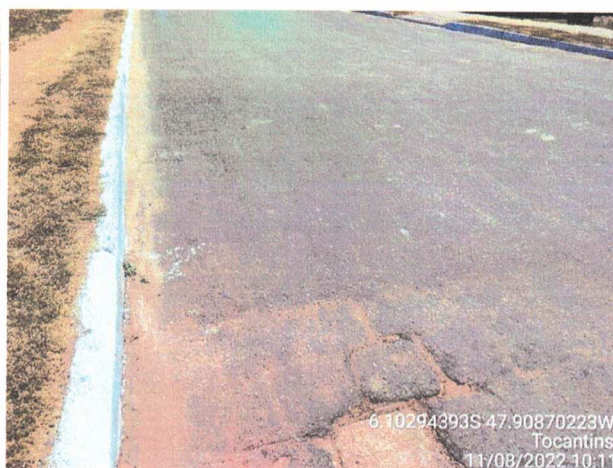
Foto 06: Pavimento com desgaste em alguns trechos.
