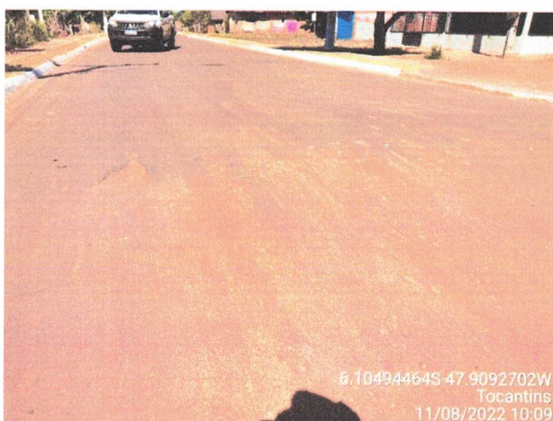
Foto 09: Pavimento com desgaste em alguns trechos.
