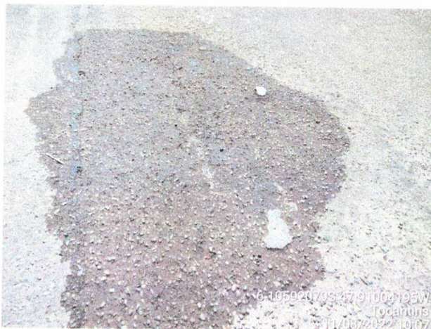
Foto 11: Pavimento com desgaste em alguns trechos.
