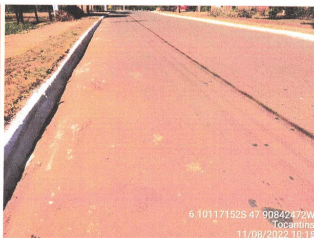
Foto 04: Pavimento com desgaste em alguns trechos.
