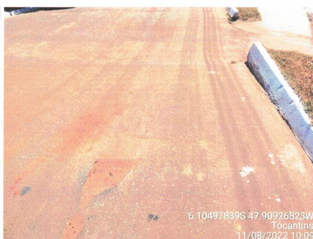
Foto 10: Pavimento com desgaste em alguns trechos.
