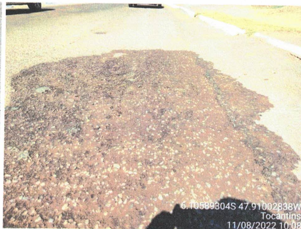
Foto 12: Pavimento com desgaste em alguns trechos.
