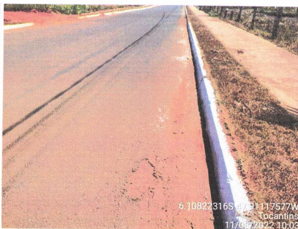
Foto 16: Pavimento com desgaste em alguns trechos.
