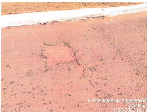
Foto 05: Pavimento com desgaste em alguns trechos.
