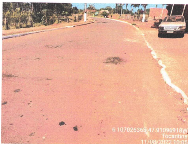
Foto 15: Pavimento com desgaste em alguns trechos.
