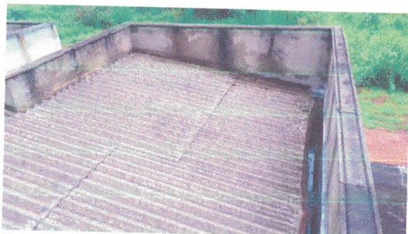
Foto 25: Calha danificada, com empoçamento.
