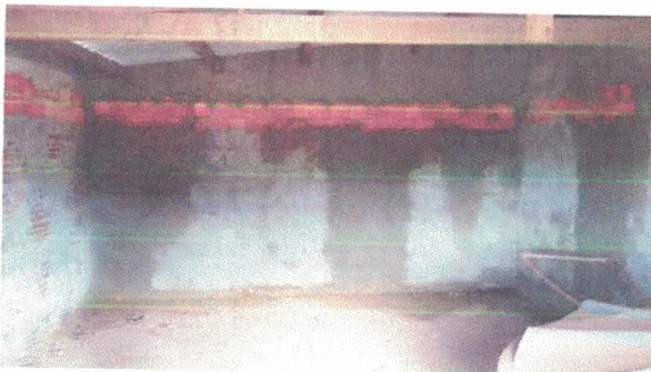
Foto 31: Infiltração na parte inferior do telhado.
