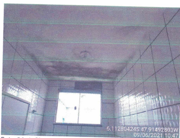
Foto 21: Infiltração em laje, proveniente do telhado.
