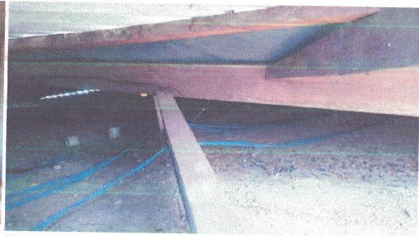
Foto 32: Telhado com problema estrutural e vazamentos.
