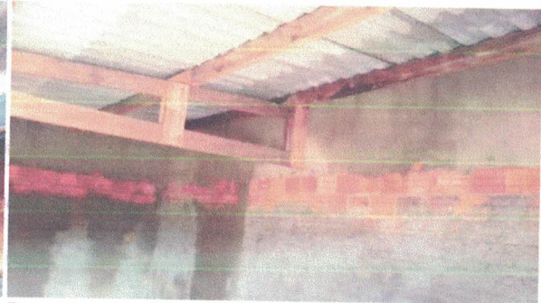
Foto 30: Infiltração na parte inferior do telhado.
