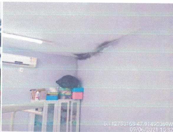
Foto 08: Infiltração em laje, proveniente do telhado.
