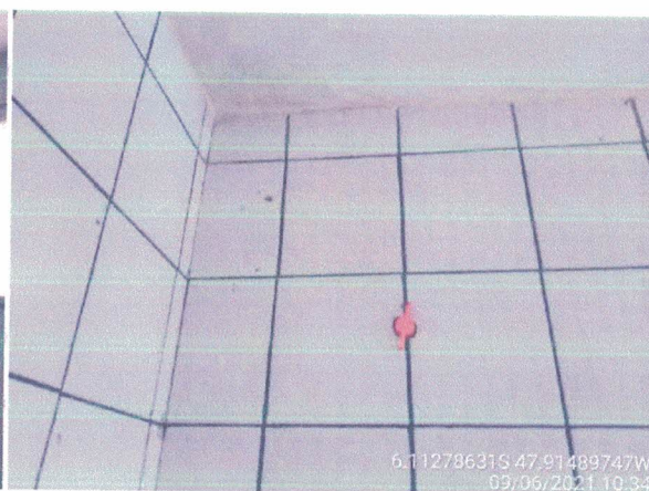
Foto 10: Infiltração em laje, proveniente do telhado.
