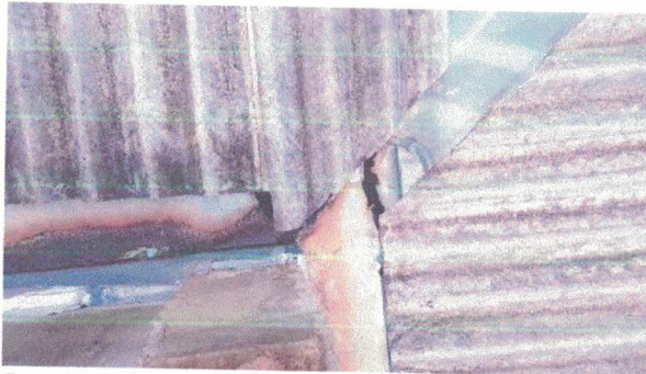
Foto 27: Calha danificada com rasgos, peça solta.
