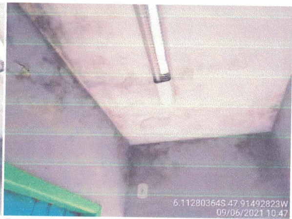
Foto 18: Infiltração em laje, proveniente do telhado.
