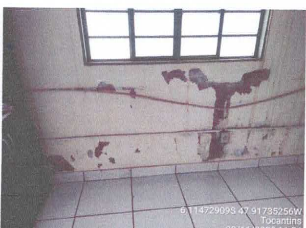
Foto 78: Sala da coleta: paredes com rachaduras. Paredes com infiltração. Fiação exposta, esquadrias danificadas.
