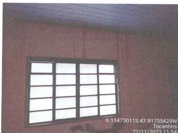
Foto 77: Sala da coleta: paredes com rachaduras. Paredes com infiltração. Fiação exposta, esquadrias danificadas.
