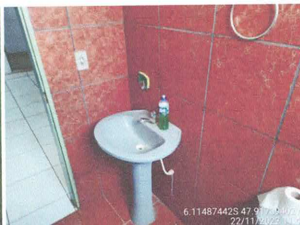
Foto 48: Banheiro do gabinete a ser reformulado.
