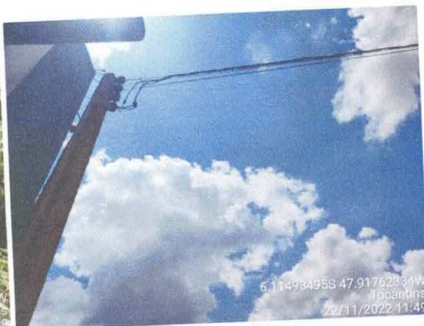
Foto 14: Padrão de energia existente.
