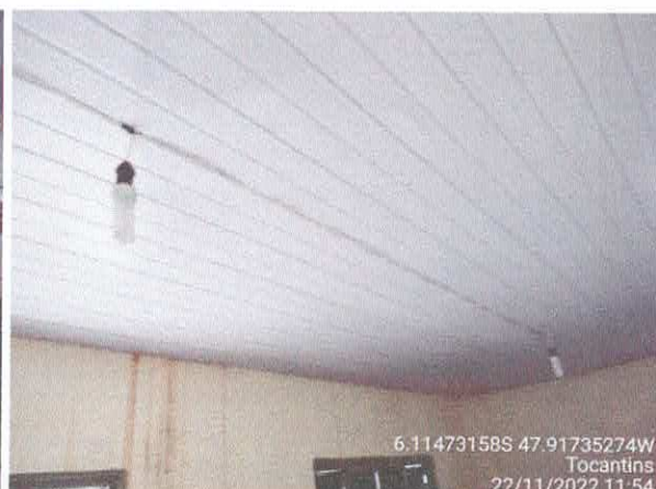
Foto 76: Sala da coleta: paredes com rachaduras. Paredes com infiltração. Fiação exposta, esquadrias danificadas.
