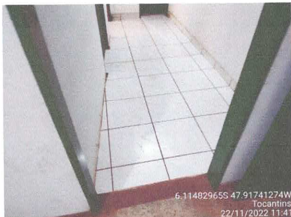
Foto 45: Acesso ao gabinete com desnível no piso.
