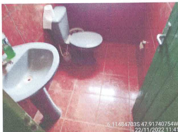
Foto 47: Banheiro do gabinete a ser reformulado.
