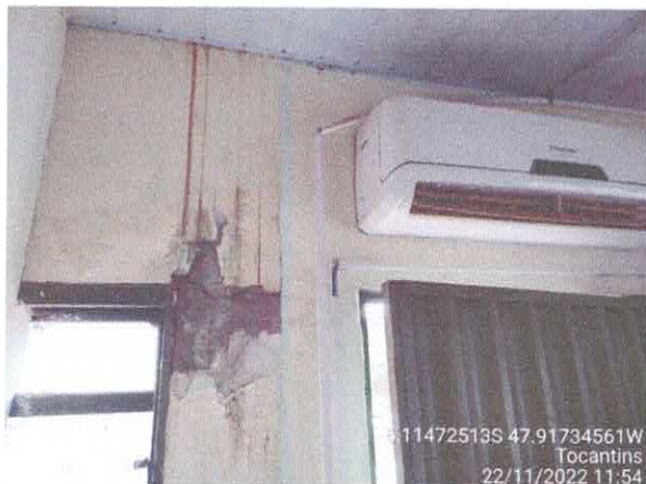
Foto 75: Sala da coleta: paredes com rachaduras. Paredes com infiltração. Fiação exposta, esquadrias danificadas.
