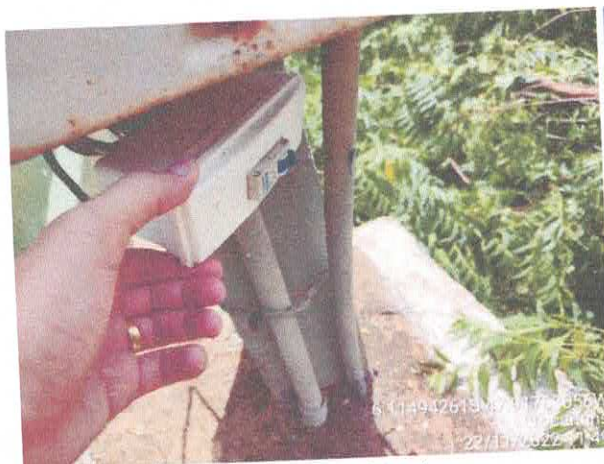
Foto 13: Padrão de energia existente.
